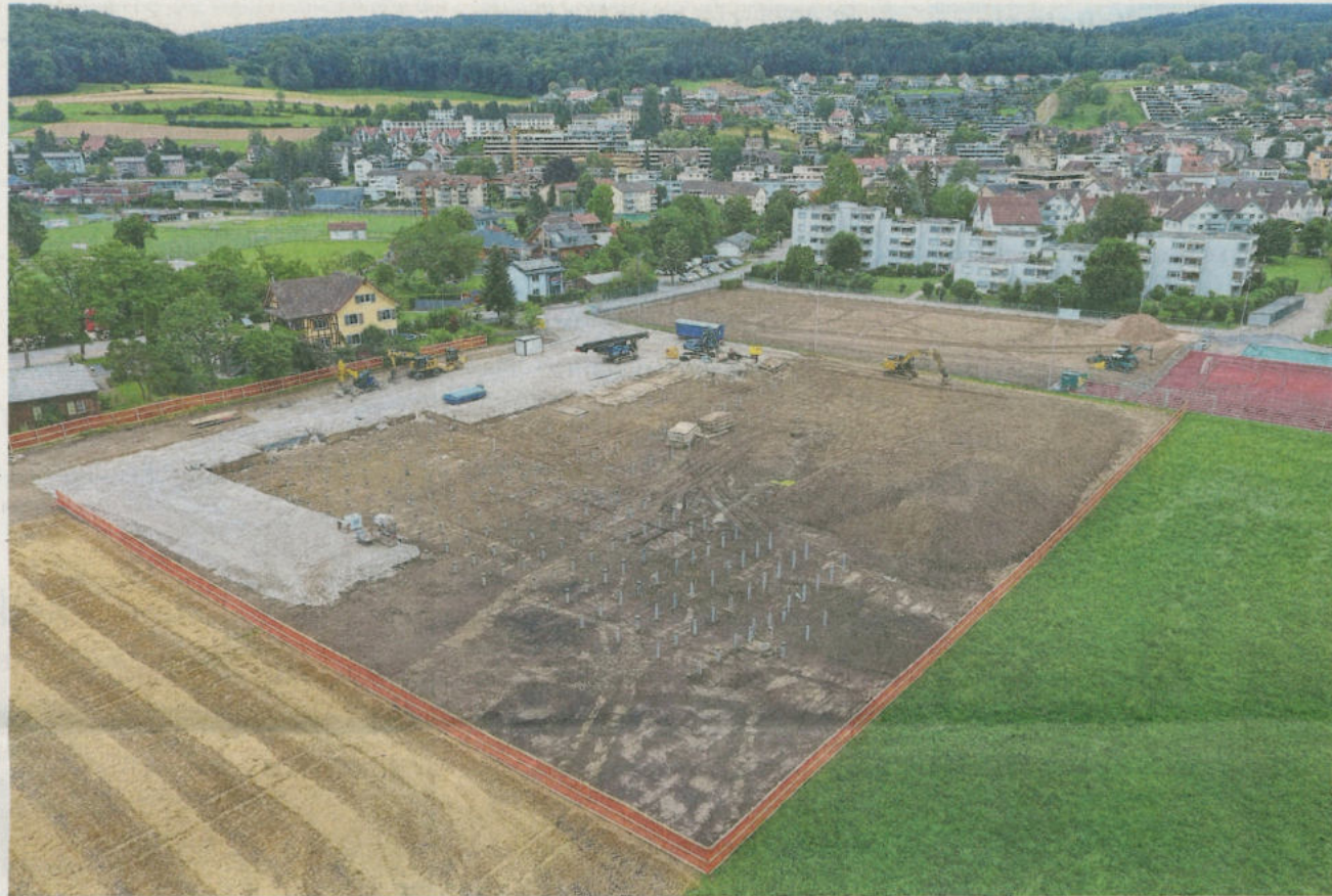
Bis Mitte Juli werden die Betonpfähle auf dem Giessenareal in Affoltern im Boden versenkt. (Bild Stefan Felder)
